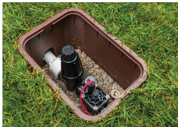
PCZ-101 in einer Mehrzweck-Box installiert
